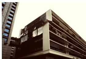
地震で 6 階部分がつぶれた神戸市役所 撮影：1995 年 5 月
